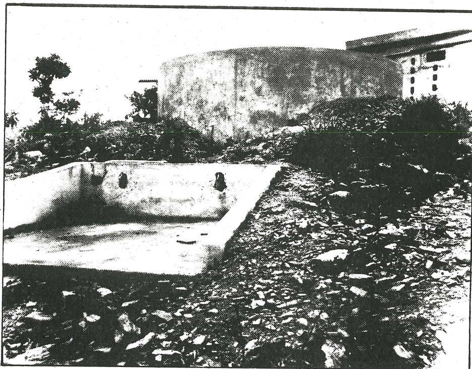
Den nya regnvattencisternen vid nya elevhuset. La nouvelle citerne de l'eau à côté du nouveau dortoir.
